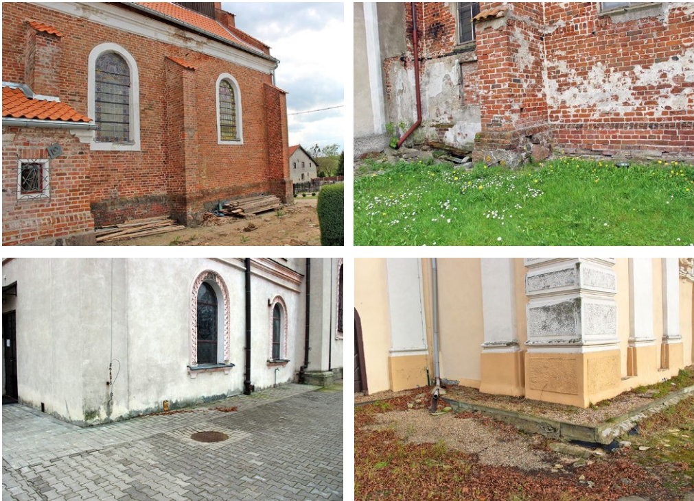
Abb. 5a, b, c, d Fehlende Gefälle, Vertiefungen, harte Oberflächen und zufällige Hindernisse sind ebenfalls häufige Ursachen für Feuchtigkeitsprobleme
