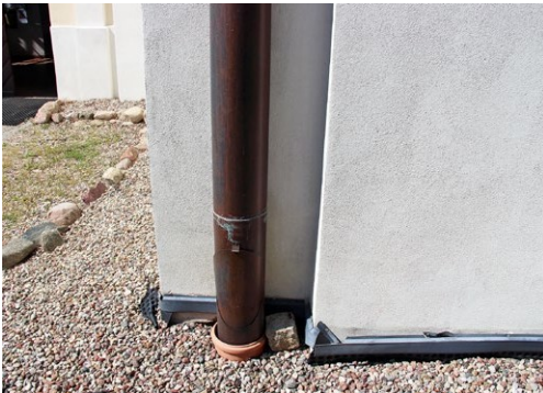
Abb. 4a, b, c Wandleisten, die das Eindringen von Wasser hinter die Folie verhindern, werden uneinheitlich eingesetzt, sind oft unvollständig und sind daher unwirksam
