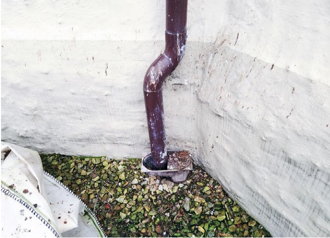
Abb. 7a Fehler bei der Ausführung von Dachrinnen- und Regenwasserableitungssystemen, verstopfte Abflüsse – sind leider keine Seltenheit
