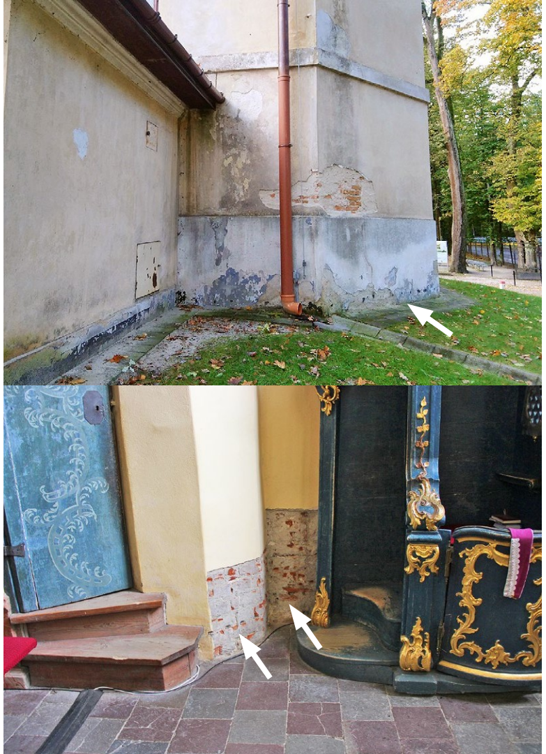
Abb. 3a, b Auch horizontale Abdichtungen sind oft lückenhaft, inkonsequent und manchmal sogar schädlich für die historische Substanz
