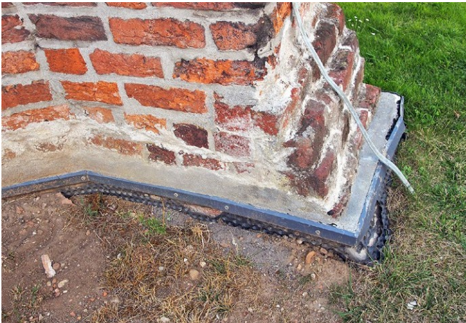
Abb. 9 Im selben Gebäude – korrekt verlegte Pilzfolie, abgeschlossen mit einer Abschlussleiste. Doch nach Jahren haben Alterungsprozesse des nicht beständigen Kunststoffes dazu geführt, dass die Folie bereits zerfallen ist und zwischen ihr und der Leiste ein deutlicher Spalt zu sehen ist. Infolgedessen dringt bei jedem Regen Wasser hinter die Leiste und befeuchtet zusätzlich den Fundamentbereich dieses 700 Jahre alten Bauwerks
